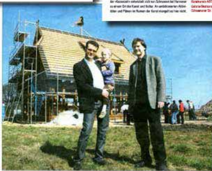
Planer und Vermarkter des Fachwerkhofes feiern mit Dirk Felsmann (links), seine Tochter Iola (5) und Architekt Albin Homeyer sind beim ersten Richtfest am Steinhorstweg dabei. Foto: Lutz
